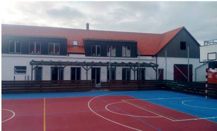
Další pohled na Komunitní centrum v Bělči s dokončenou fasádou. Dokončení celého projektu se předpokládá na konec února. FOTO: Filip Kašťánek
